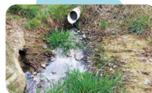
Rejet d'eaux souillées
