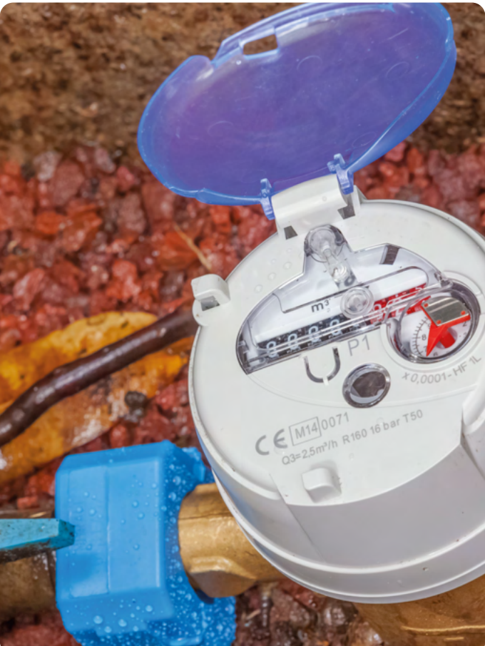
Compteur d'eau avec vanne d'arrêt © Adobe Stock
